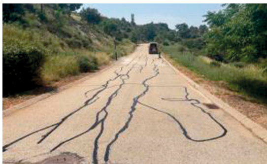
El paso de Filomena deterioró el pavimento / Ayto Ambite
