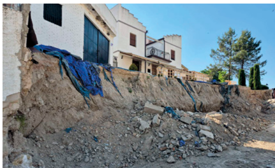
El muro se derrumbó durante la gota fría de 2019 / Ayto Villar del Olmo
